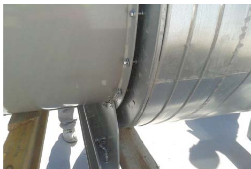
Rys. 5. Zdjęcie miejsca montażu wentylatora oddymiającego do instalacji
