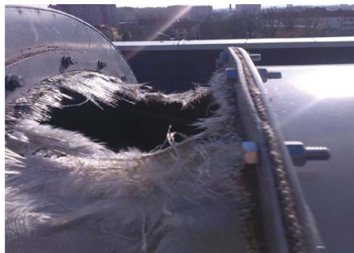
Rys. 6. Zdjęcie kompensatora drgań zniszczonego na skutek niewłaściwego montażu
